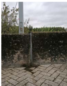
Volledig verzakte dijkwand door onderspoeling
